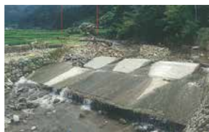
▲農業用施設被害の例（頭首工の損壊）
