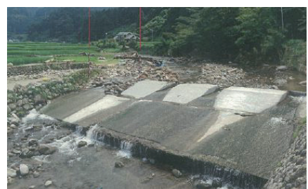
▲農業用施設被害の例（頭首工の損壊）
