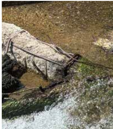
鉄筋がむき出た魚道(一部)
