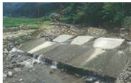
▲農業用施設被害の例（頭首工の損壊）
