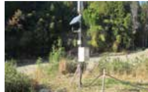
▲通信装置・雨量計
