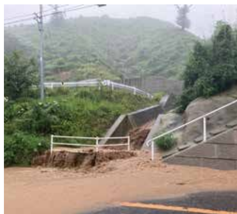
国道に流れ出る砂防ダムからの濁流
