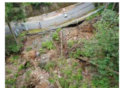
公共災害 天ヶ谷・宝ヶ谷線 (路肩崩壊)
