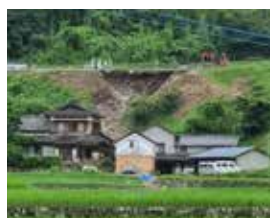
BRT専用道の被害後
