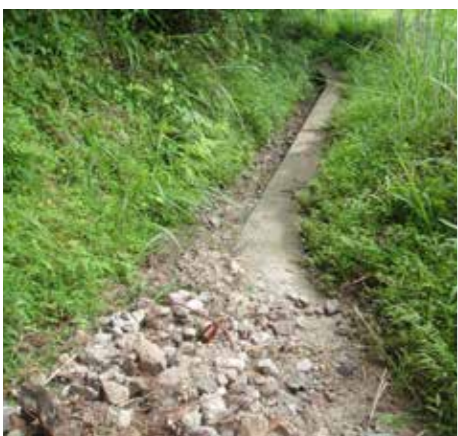
大雨後BRT専用道工事場から流れ出た土砂
