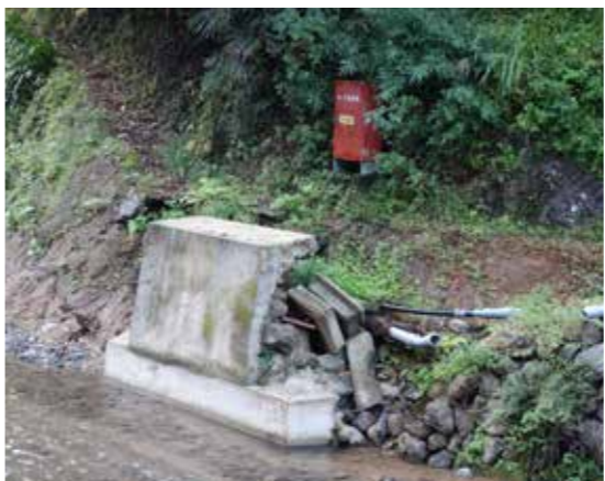
被災した第二鶴橋
