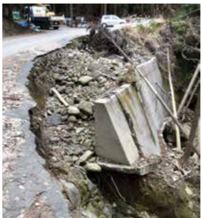
林道被災箇所
