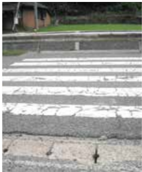
消えかかった横断歩道
