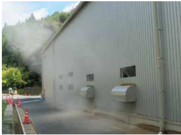
どうする粉塵対策(ライスセンター)
