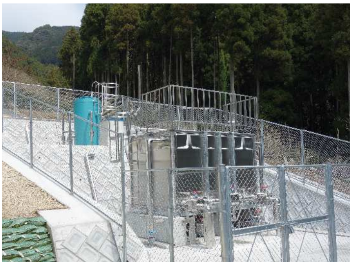
塔の瀬地区飲料水給水施設
