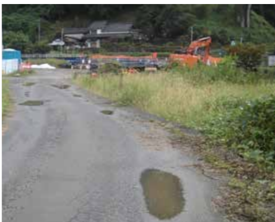
工事で傷んだ村道
